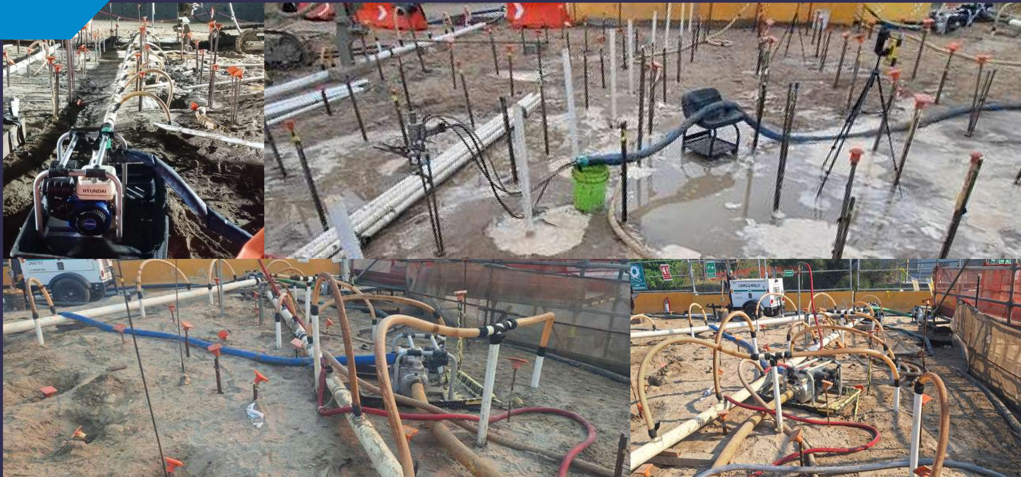
Abatimiento de N.A.F. con sistema wellpoint como servicio complementario a la inyección de polímero para estabilización de suelo a cargo de la empresa INTEC
